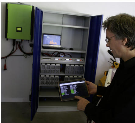
Im Schrank sind die Batteriemodule des 2nd-Life-Batteriespeichers zu erkennen, links in Grün der Wechselrichter. Ralph Schnyder zeigt, wie der Batteriespeicher fernüberwacht werden kann.
