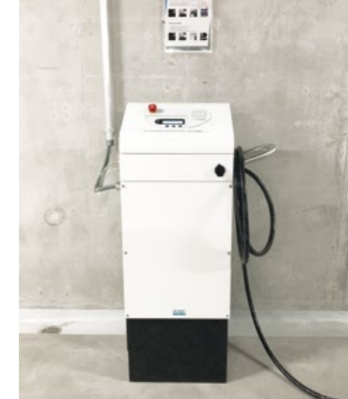
Eine von zwei bidirektionalen Ladestationen in der Tiefgarage der Überbauung. Die Nutzung eines Carsharing-Mobils ist besonders für Kurzeinsätze etwas günstiger als beim Anbieter Mobility.
