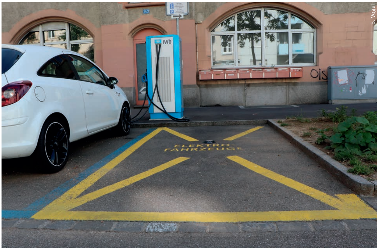
Im Rahmen eines Pilotprojekts hat Basel zehn Parkplätze aus der blauen Zone zu Ladestandorten für Elektromobile umgewidmet.
